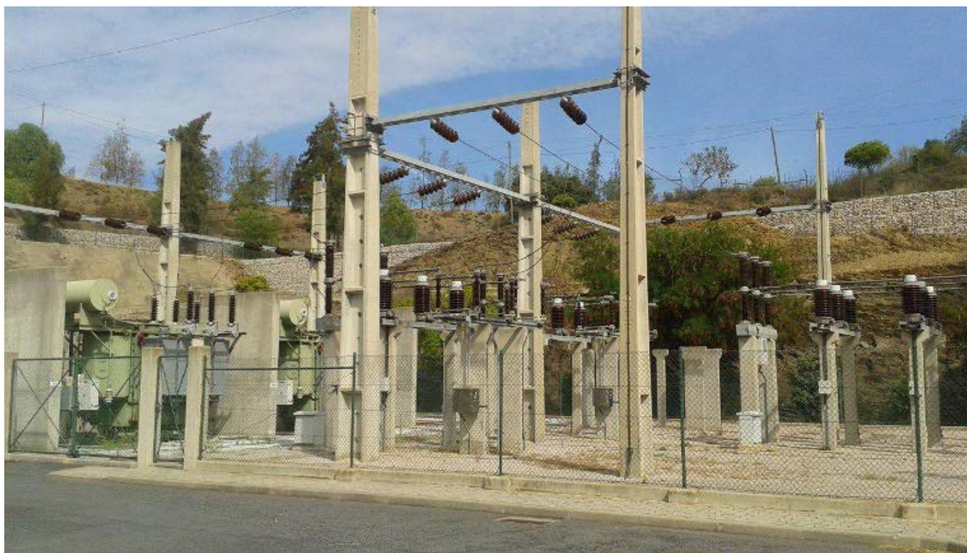
Subestação da EE1 (A.H.O.B.) – 60kV - 2 x 16 MVA
