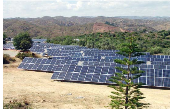
Vista parcial da instalação de painéis fotovoltaicos na ETA de Tavira
