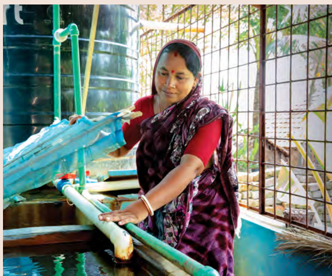
Fábrica comunitária de osmose reversa, que converte água salgada em água potável, Khulna - Bangladesh
